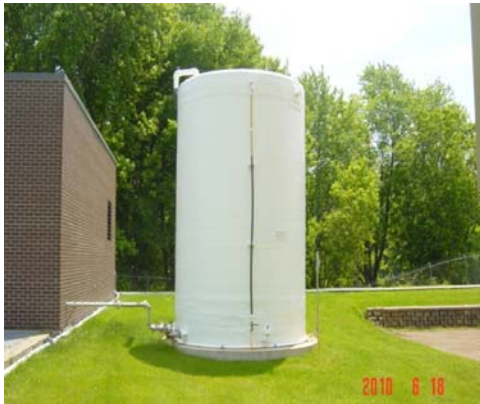
Nouveau réservoir de sulfate ferrique – l'installation complète a été réalisée par le personnel de la CCPRF
