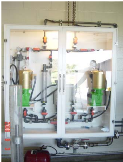
Système de pompage du sulfate ferrique
